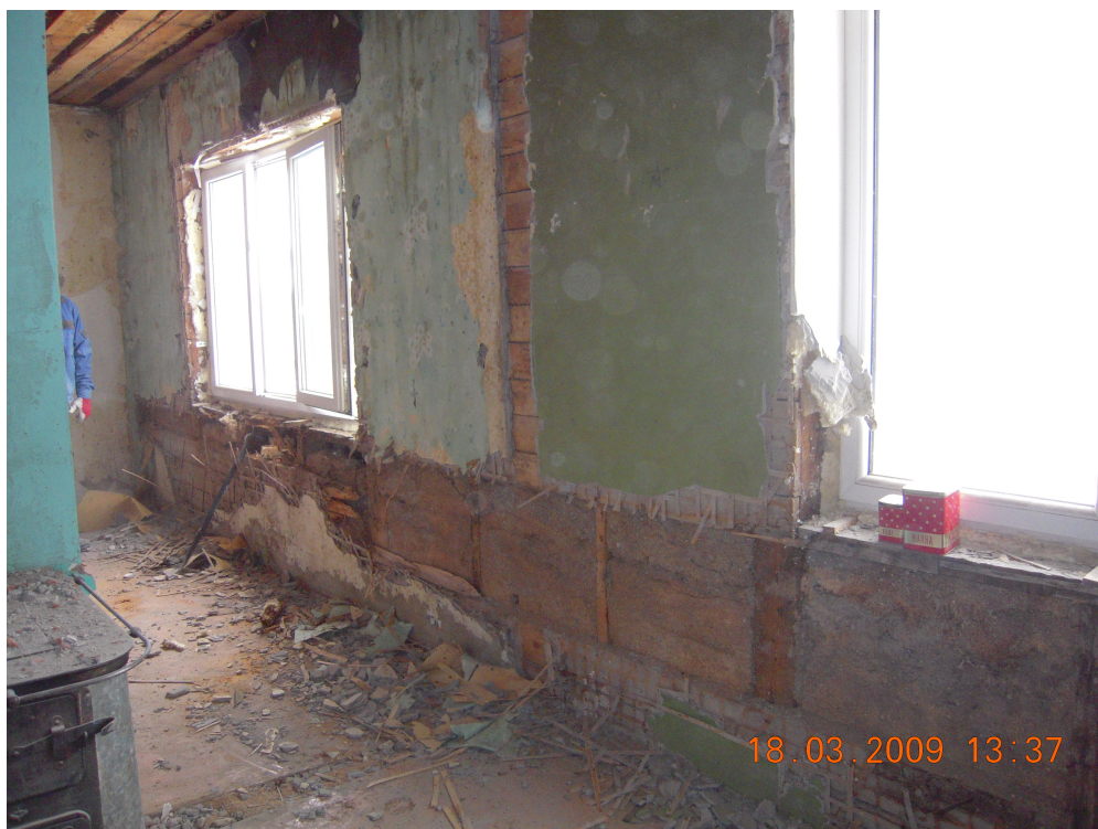
Välisseina seisukord (pildistatud 2009 teostatud remondi ajal)
