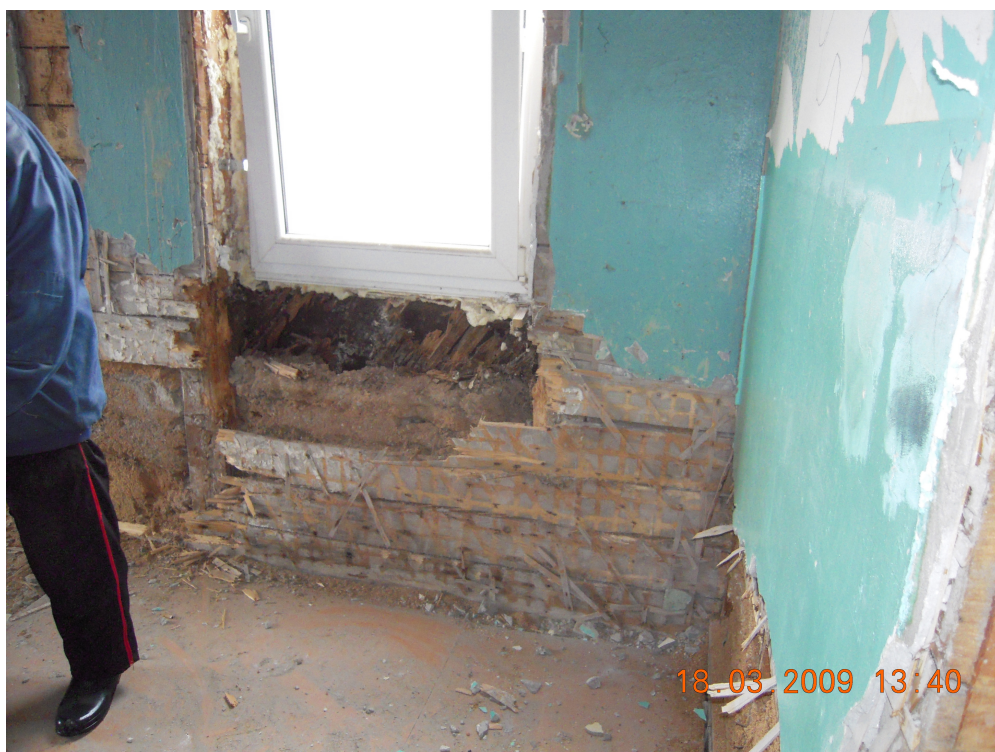
Välisseina seisukord (pildistatud 2009 teostatud remondi ajal)
