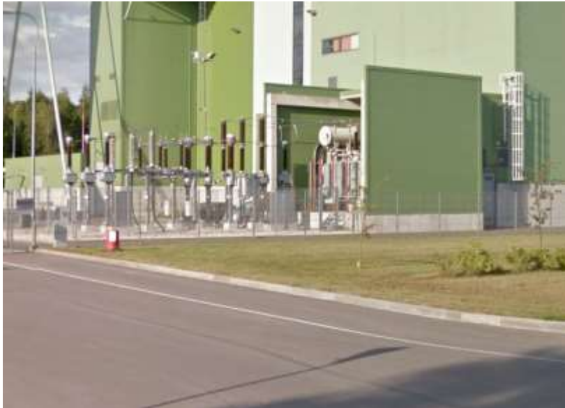
Foto 2. Illustratiivne näide alajaamast.
