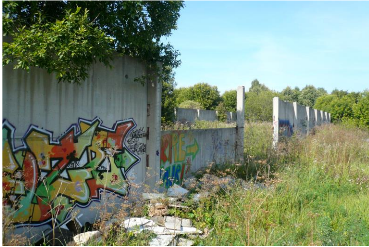
Foto 1. Vaade planeeringualalem, mida ilmestavad betoonmüürid ja Foto 1. Vaade planeeringualalem, mida ilmestavad betoonmüürid ja postid (foto august, 2013)
