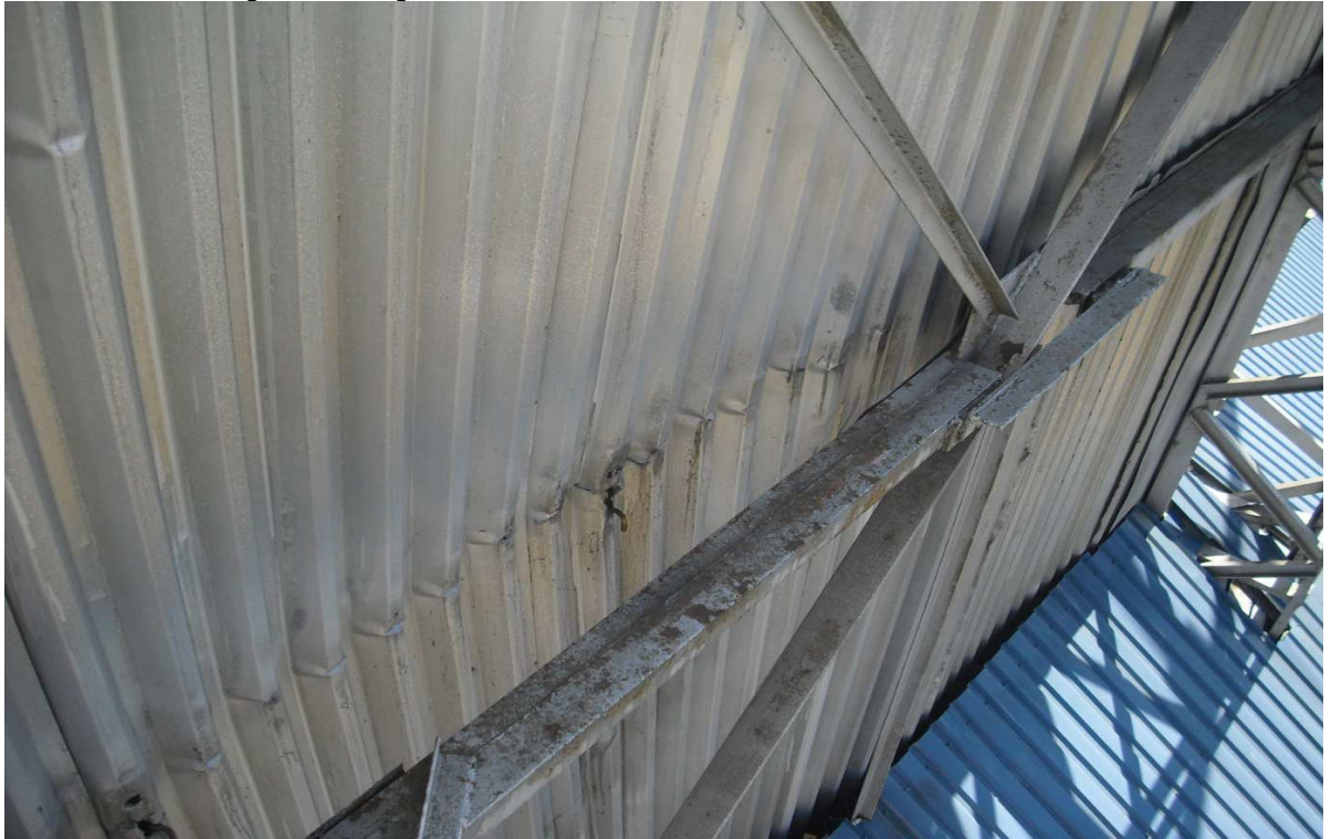
Lisa L1 Fotod olemasolevast olukorrast: Gradiiri välimised vigastused telgede 5-6 vahel
