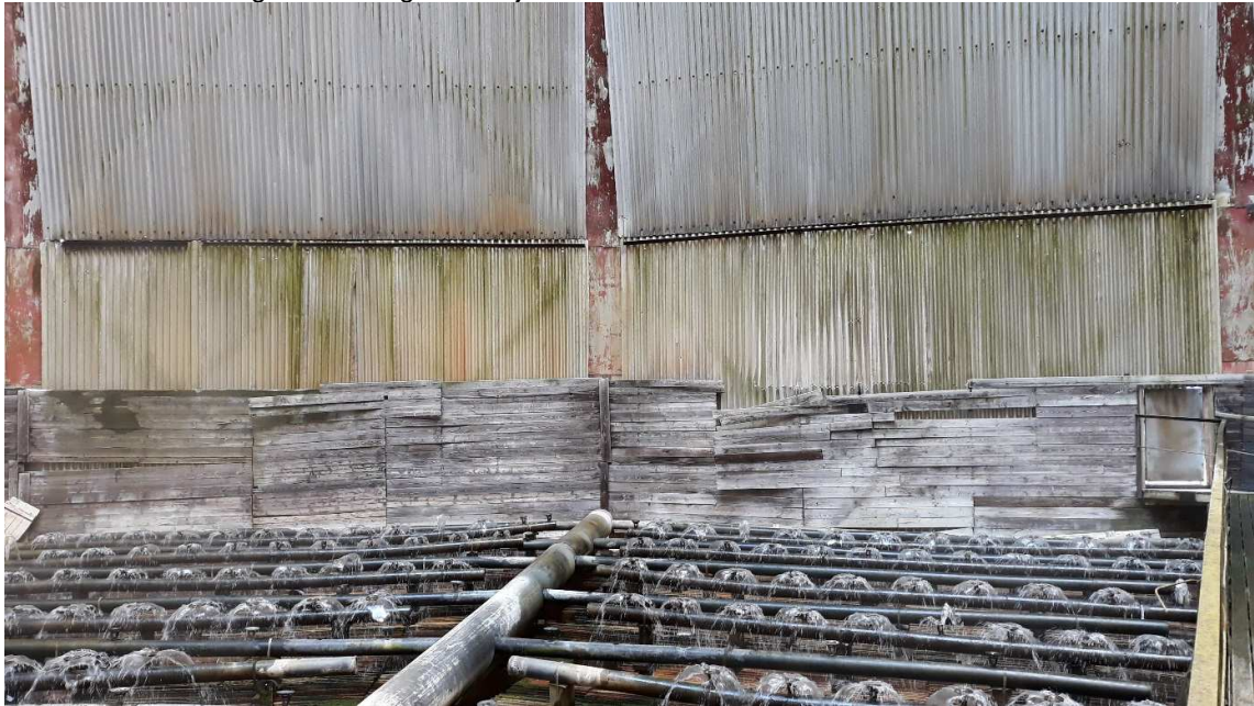
Gradiiri sisemised vigastused telgede 4-5 ja 5-6 vahel.
