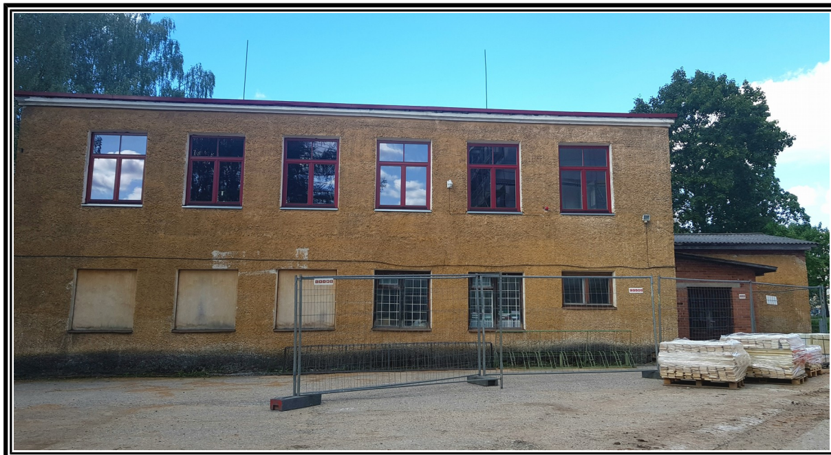
Foto 3. Vaade hoonele eest. Vaetatud on ülemise korruse aknad. Alumise korrusel on enamus aknaid kinni müüritud või kinni löödud. Alumise korruse aknad tuleb taastada (analoog - ülemise korruse aknad).
