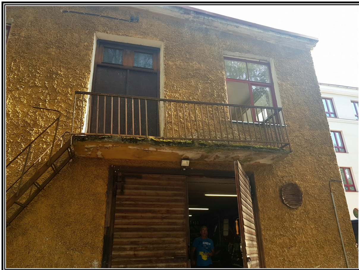
Foto 2. Vaade küljelt hoone rõdule. Rõdu on amortiseerunud ning vajab korrastamist.
