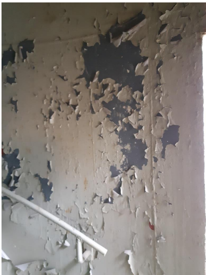
Muuga sadama Alumise tuletorni seisukorra fotod (26.02.2019)
