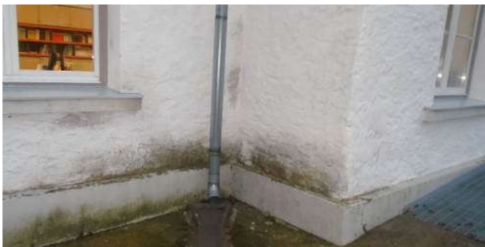
Foto: Katuse neelukohtades on sadevesi fassaadi viimistlust kahjustanud
