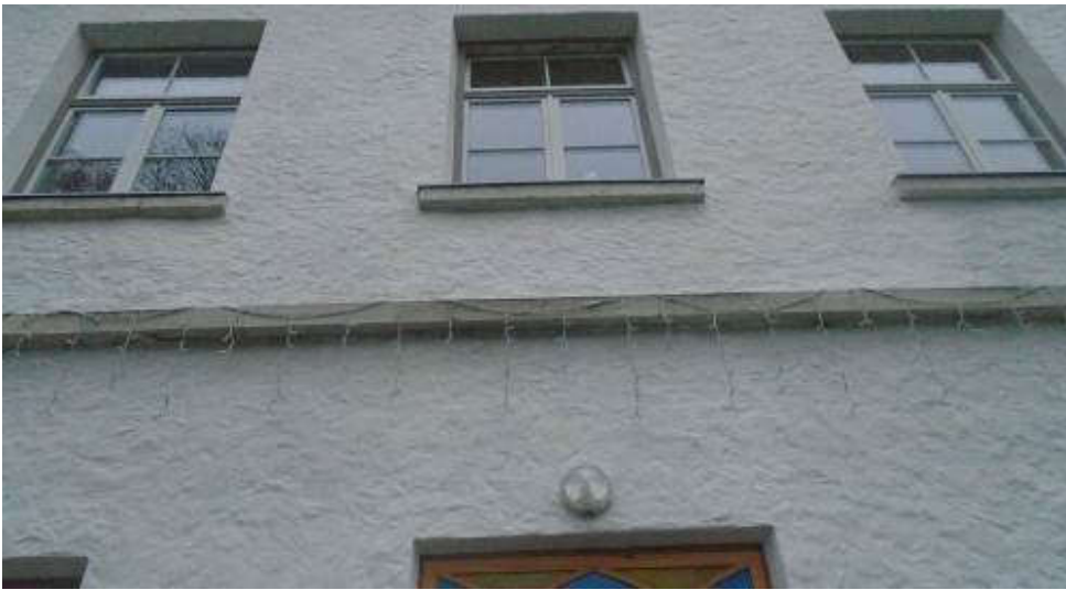
Foto: lubikrohvist fassaadid on üldiselt rahuldavas seisus, teostada värvimine
