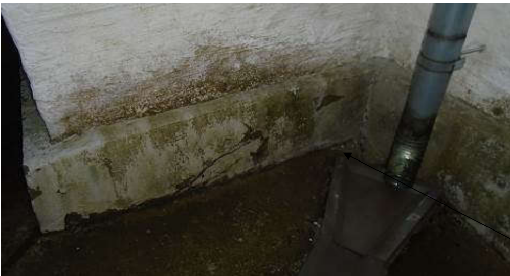
Foto: fassaadi alumine osa ja sokkel vajavad esimesel võimalusel viimistlemist
