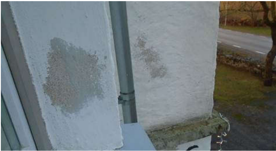
Foto: akende paled ja kogu fassaad on vaja lubivärvidega katta
