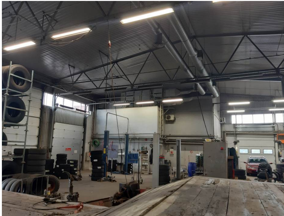
Foto 2.6. Vaade loodesse hoone sees. Parem pool oleva seina taha tuleb projekteeritav laiendus (01.10.2019).
