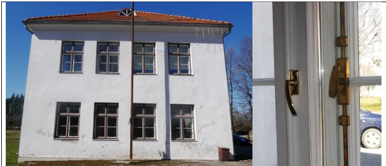
Foto 4 ja 5 Otsavaade. Koonga vallavalitsuse ajal on nii esifassaadi kui otsafassaadi korrastatud – paigaldatud on ka uued aknaraamid koos sisemiste pakettklaaside ja sulustega. Kuid kõikide akende vihmaveeplekid on veel vanad, osa nendest on paigaldatud valesti. Lahendamist vajab veelgi üks probleem – prügikastid!
