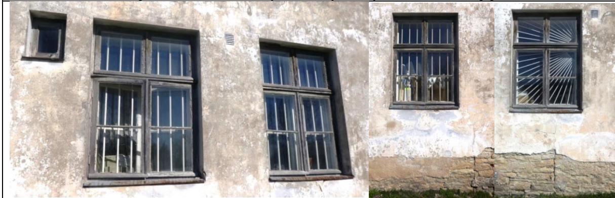
Foto 8, 9 ja 10. Vaated lõunafassaadi akendele. Väike aken, on kunagise kuivkäimla aken, mida ruumi seestpoolt pole nähagi. Umb. 10 x19 cm suurustes piitades aknaraamid tuleb restaureerida. Trellid eemaldada. Olemasolevad tuulutusavad korrastada. Nii apteek kui perearstikeskus jäävad loomuliku ventilatsiooniga. Aknad värvida väljastpoolt sama tooniga nagu otsaaknadki.
