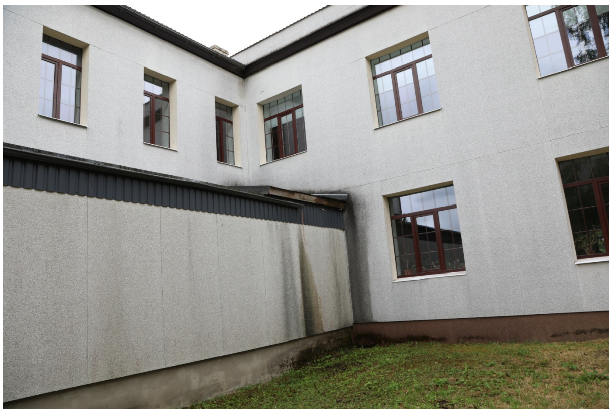
Foto 13. Vaade vahekoridori ja vana hoone liitumisele. Eemaldunud veetoru ja renniosa tuleb tagasi paigaldada.
