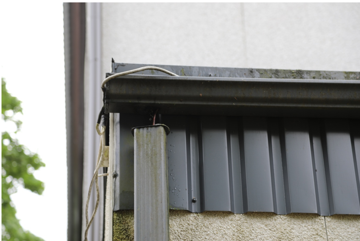
Foto 12. Lahtine vihmaveetoru tuleb kiiremas korras remontida. Vajadusel välja vahetada defektsed detailid.
