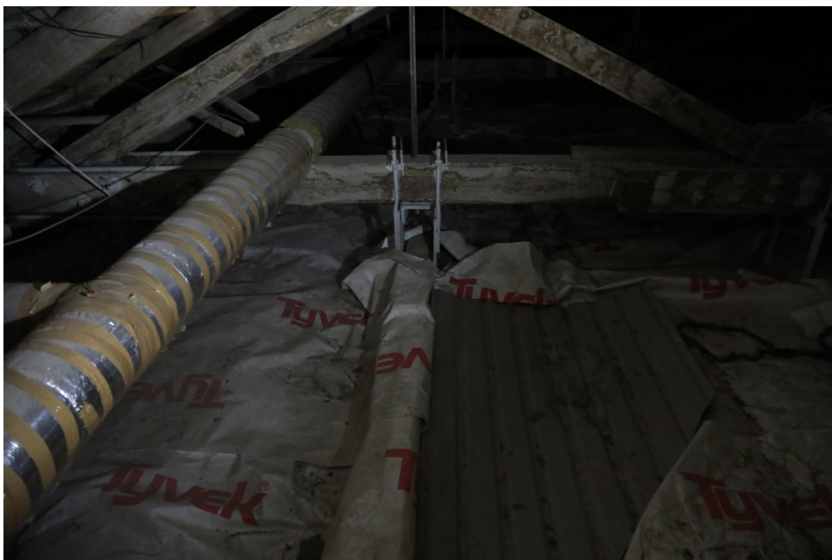
Foto 20. Vaade pööningule. Tulevikus võiks planeerid kogu pööningu uuesti soojustamist koos korraliku bituumentaurutõkke ja tuulesuunajate paigaldamisega ning pööningu ja seina soojustuse sidumisega. Enne seda tuleb katus saada veekindlaks. Pööningule võiks kaaluda ka valgustuse ja katuseakende paigaldamist.
