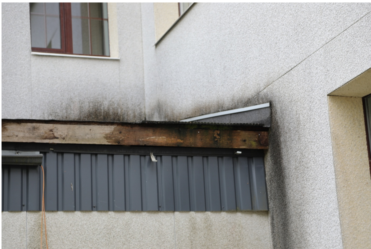
Foto 14. Katuse servale tuleb paigaldada servaplekk. Kahjustunud laud tuleb välja vahetada sügavimmutusega laua vastu. Paigaldada uus renn ja äravoolutoru.
