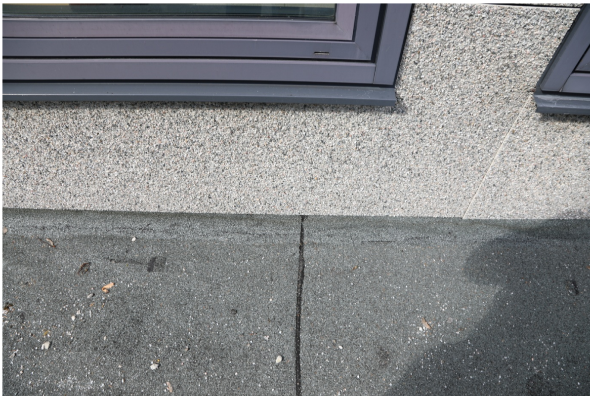
Foto 4. Fassaadi pääsev sademevesi liigub edasi katusesse.
