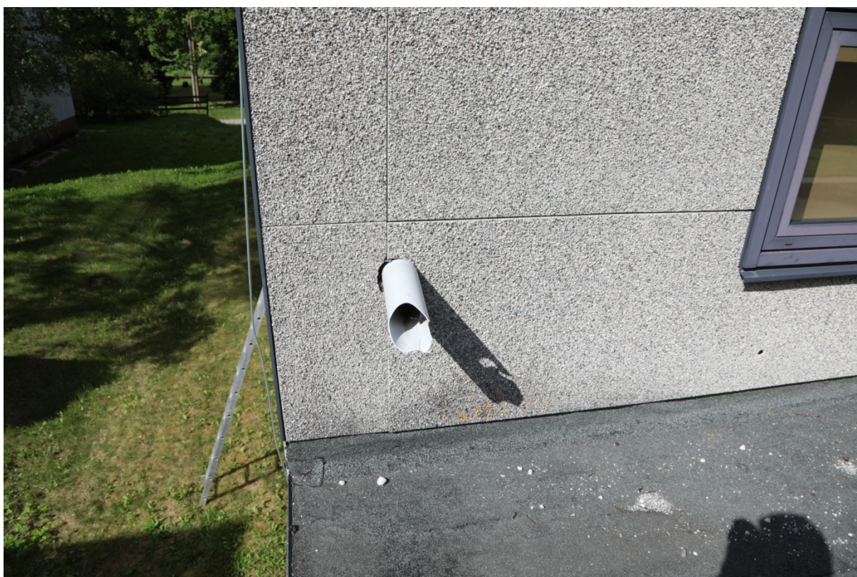
Foto 22. Sademevee allaviigutoru väljund ja fassaadi liide ei ole veetihe. Sademevee toru paigaldamine fassaadi sisse ei ole hea lahendus.
