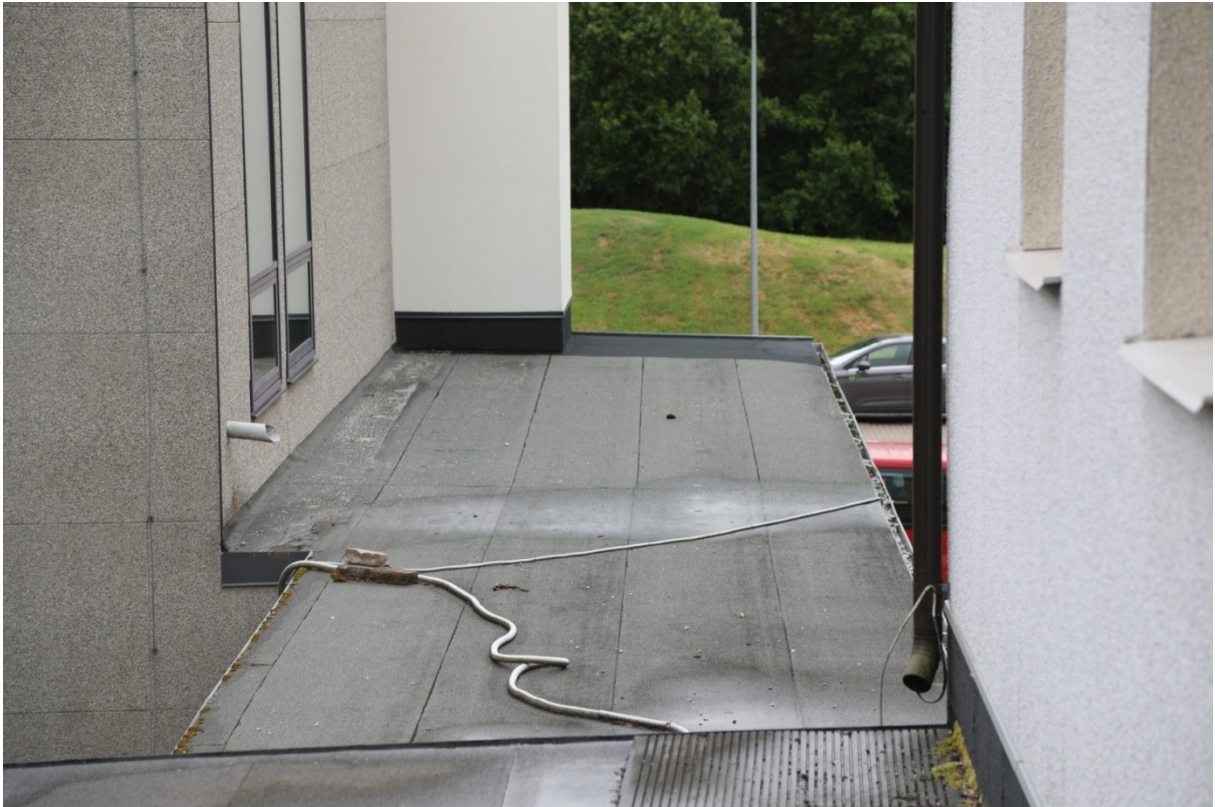
Foto 1. Vaade probleemsele koridori katuse ja võimla seina liitekohale.
