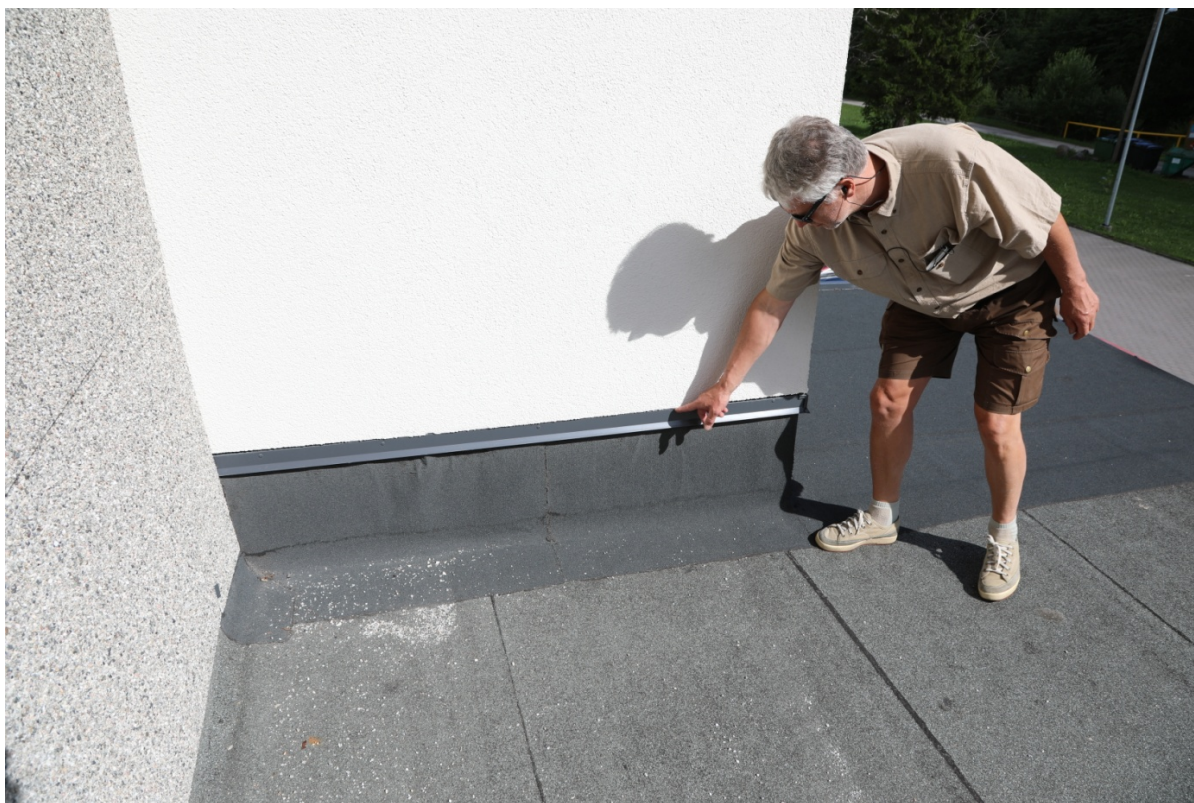
Foto 3. Katuse ja õhekrohviga kaetud liftišahti fassaadi liitekohas on hüdroisolatsiooni ülespööre kaitstud seinaplekiga. Pleki ja seina liites olev silikoon tuleb eemaldada ja liide tihendada polüuretaanmastiksiga.
