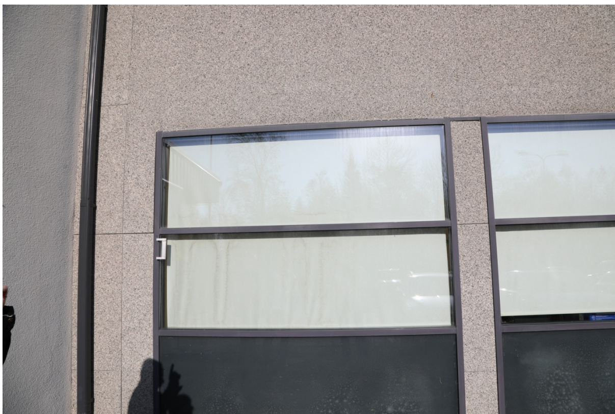
Foto 24 . Akende ja seina liide ei ole veetihe ja sademevesi pääseb hoonesse.
