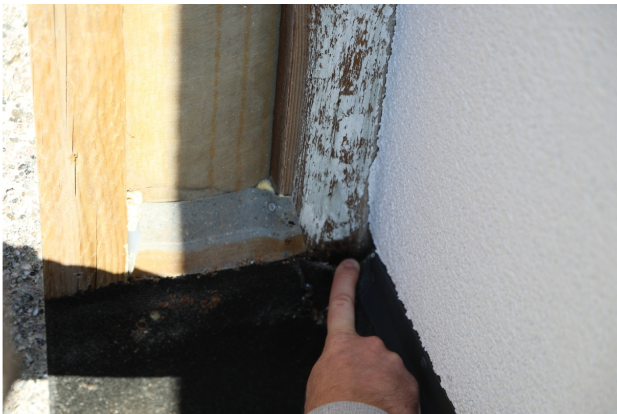
Foto 9. Seina nurk ei ole veekindel ja vesi pääseb hüdroisolatsiooni taha.
