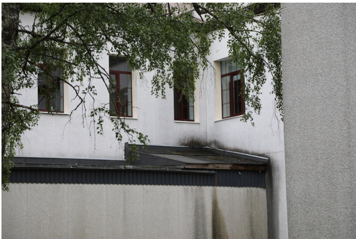
Foto 18. Katusel puudub osaliselt renn. Katmata servalaud on kahjustunud.
