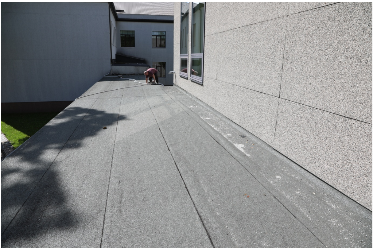
Foto 2. Vaade koridori osa lamekatusele suunaga vana hoone poole. Seina ääres on vee- ja veeaurukotid. Hüdroisolatsiooni ülespööre on tehtud pikipaaniist, mitte ristipaaniidest nagu näeb ette paigaldustehnoloogia.
