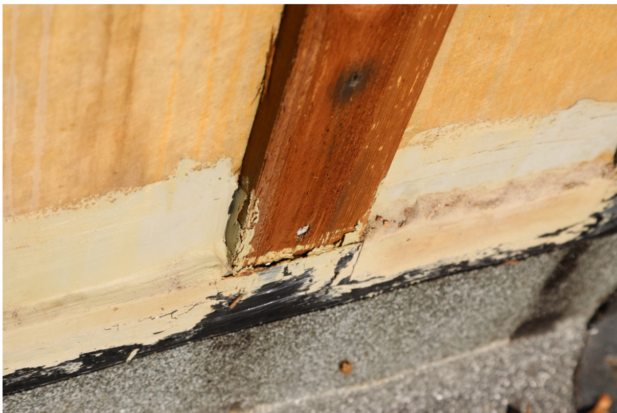
Foto 7. Kuna fassaadikate ei ole veetihe, siis pääseb sademevesi katteplaatide taha ja edasi nii katusesse kui hoonesse. Liidet on püütud tihendada, kuid see ei ole andnud tulemust.
