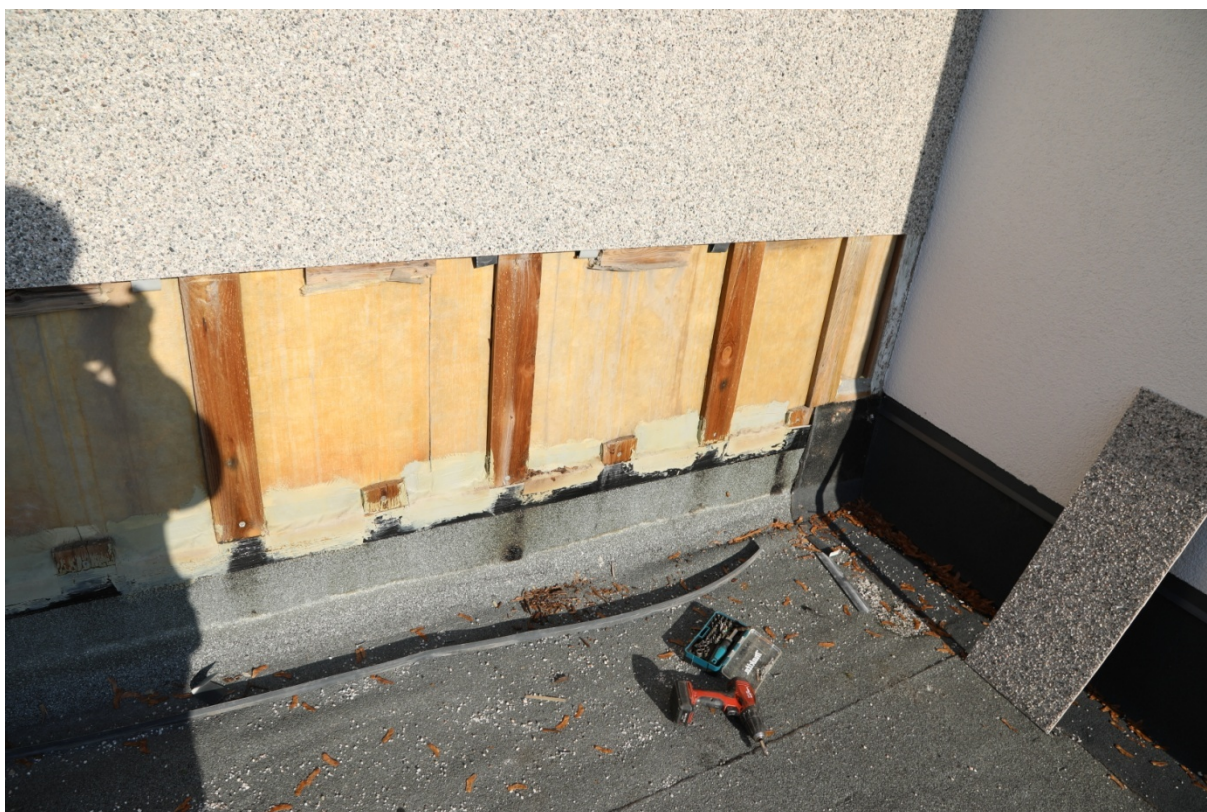
Foto 6. Avatud fassaadil on näha puitroov ja hüdroisolatsiooni ülespööre seinale. Fassaadikate on kinnitatud horisontaalvuugis puitklotsidega ja selle veetihedust tahetud saavutada vahekohtadesse paigaldatud plekiribadega.
