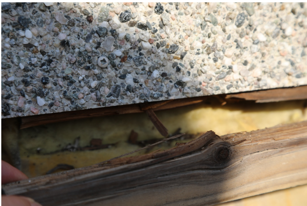
Foto 17. Horisontaalvuukidesse paigaldatud klotsid on osaliselt fassaadi sattunud sademeveest kahjustunud.
