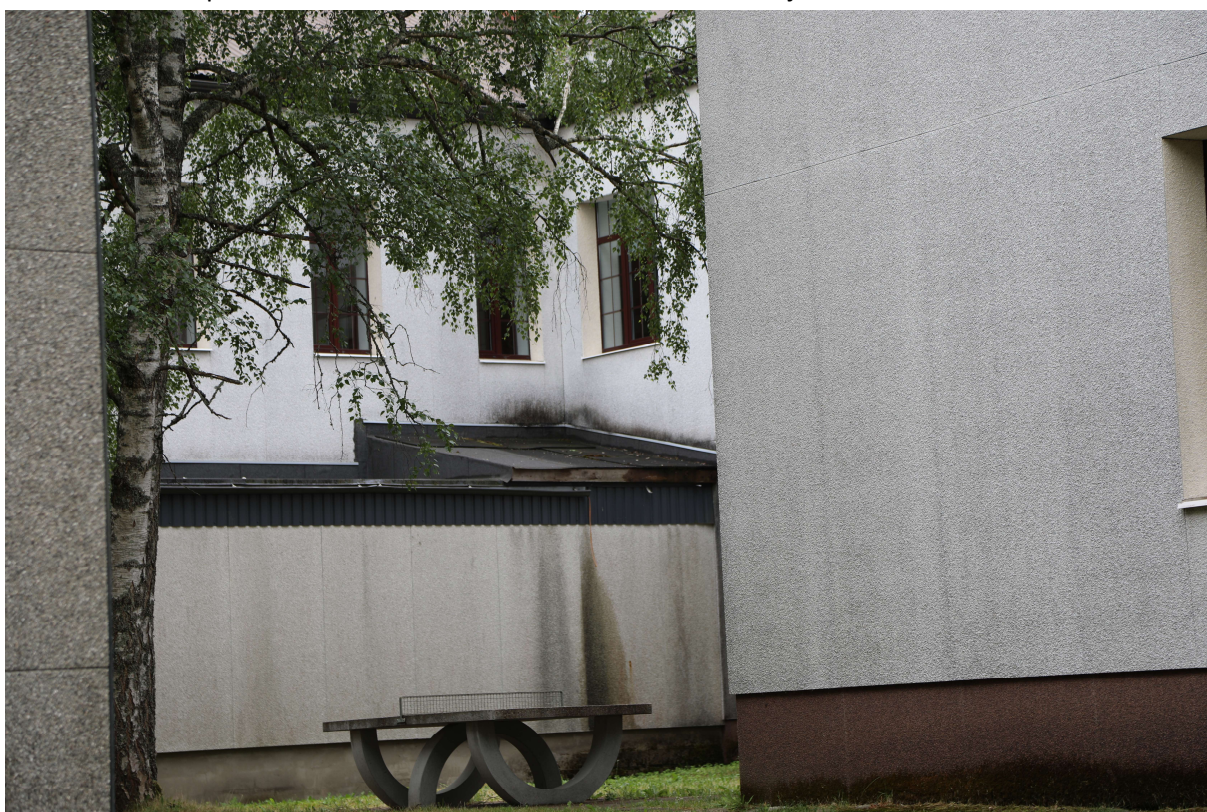
Foto 19. Puuduva renni ja allviigutoru pärast on fassaad kahjustunud.
