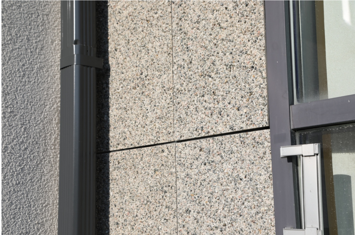
Foto 25. Fassaadiplaatide liiteid on püütud tihendada plekiribadega.
