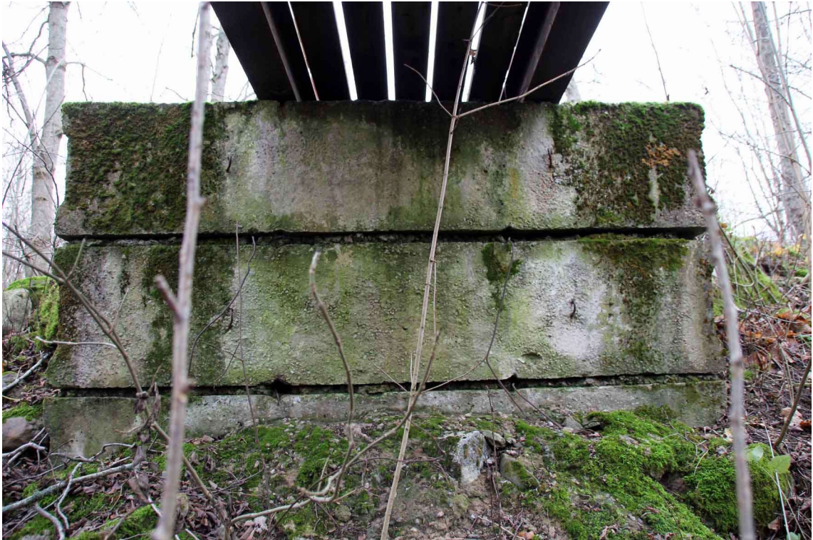
Foto 9. 15 m silla paapoolne tugi koosneb pinnasele paigaldatud betoonplokkidest. Nõlv vajab erosioonikaitset.
