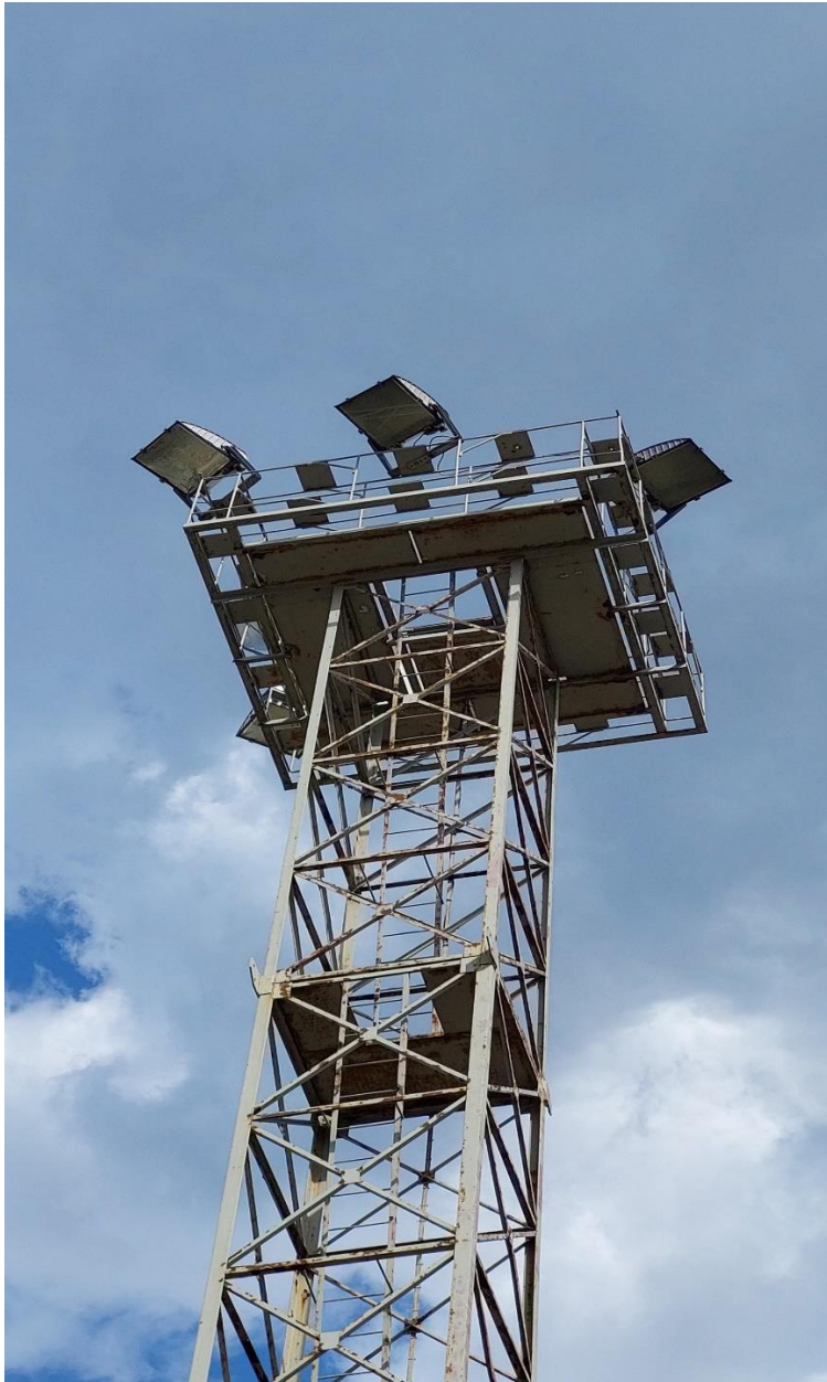
Foto 2; 3; 4. Mastid ja asendatavate valgustite asukohad ja kinnitused mastil.
